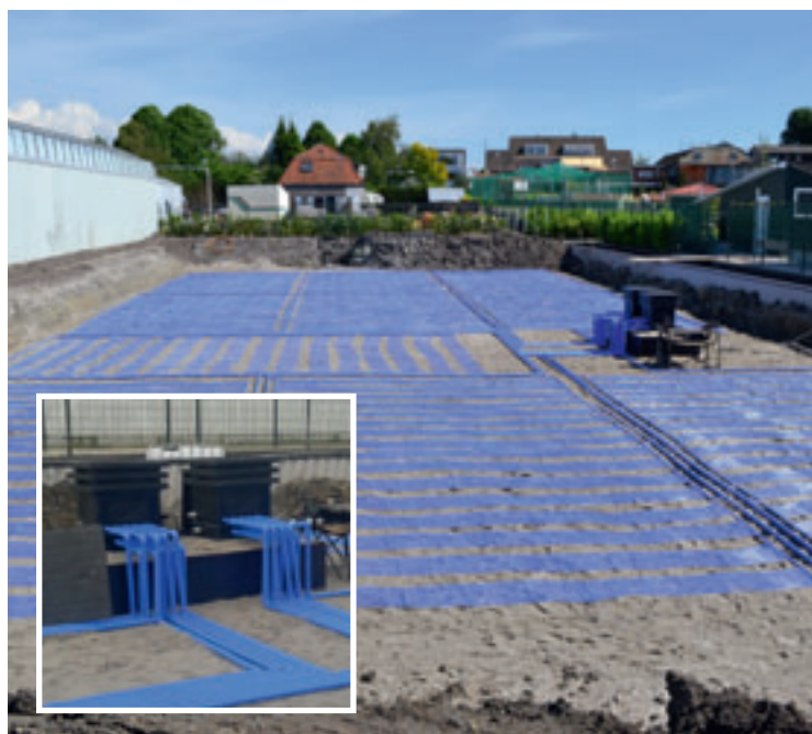
De aardwarmtecollector is aangesloten op een verdelerput met vijf groepen.
